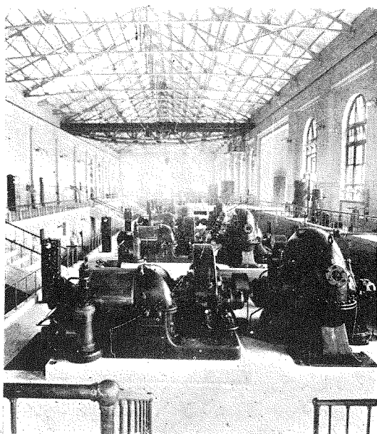
(6) 第一送水ポンプ場内部
