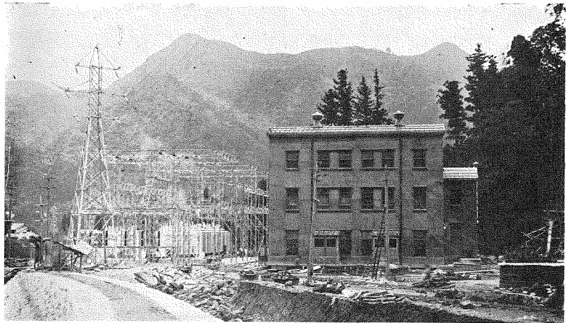
(3) 發電所及屋外變電所 (階下はコンパート室、蓄電池室、充電機室、階上は配電盤室、直流母線室、事務室、階應接室に充用)
