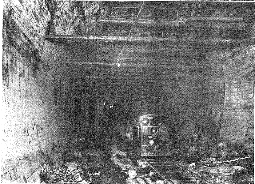
(6) 上、水路隧道 水路隧道の壘築を終つた部分。徑間高さ共に6.82米である。混凝土用吊足場の上より見た所。(7) 下同上、水路隧道 蓄電機關車の通つて居る線は掘出及支保工等の材料運搬に用ひ上の吊足場は混凝土運搬に用ひる
