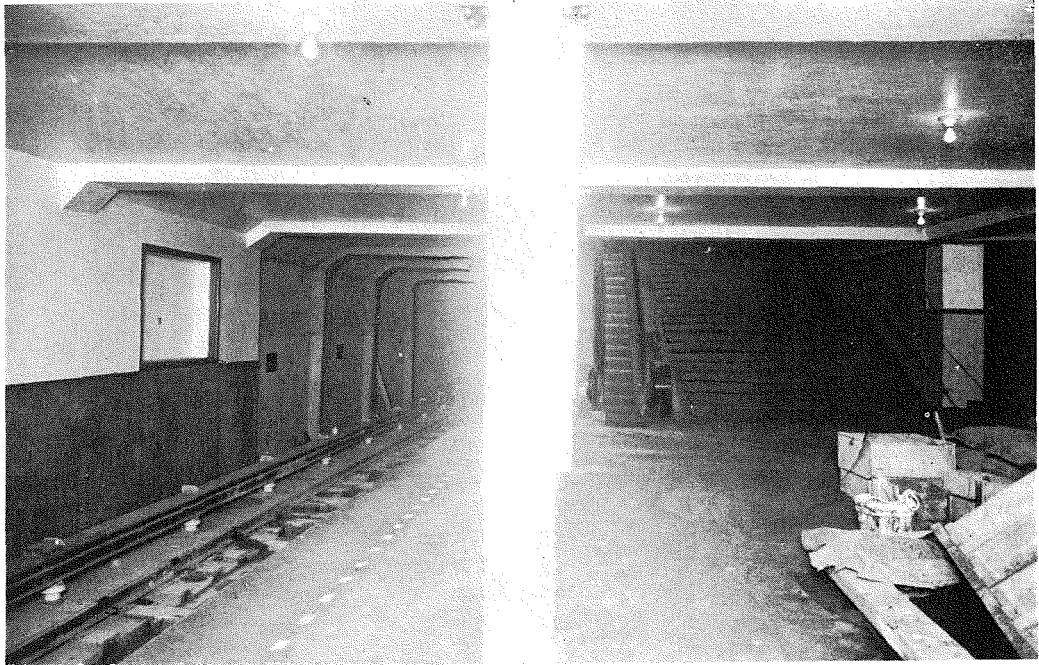
(1) 日本橋三越前停留所乗降場(工事中)向つて右の前方は中二階への階段及びエスカレーター。
