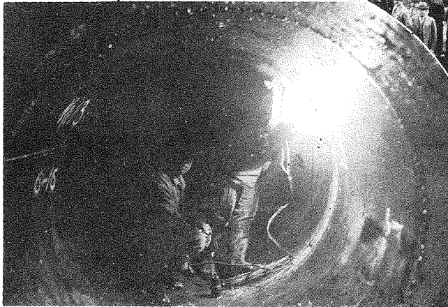
(下) 日本電氣銲接機株式 會社が施行せる日本海 電氣會社小日川第二發 電水路用鐵管の電弧銲 接作業狀況。
