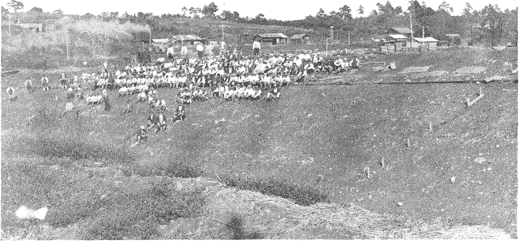
(第9圖) 山口貯水池堤盛土工事の一部景にして、法面約80尺の出來高を示す。尙盛土は此上に約四倍の高に施工して堤頂に達するものなり。法の斜面に處々遺形の丁張を存せり、此面は接水面なり。
