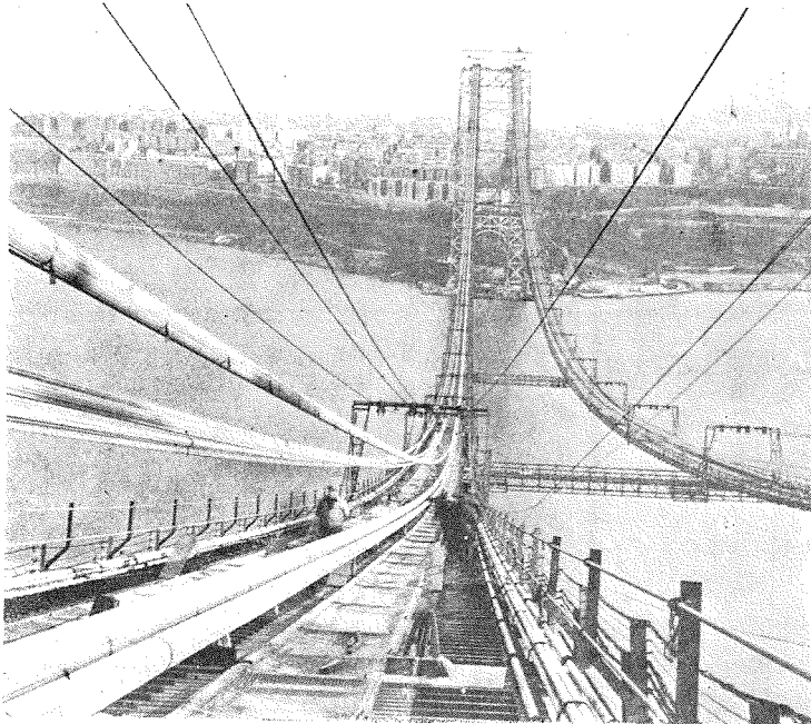
(15) ケーブル架設工事。ニューシャーザー塔より見たる北側棧橋。
