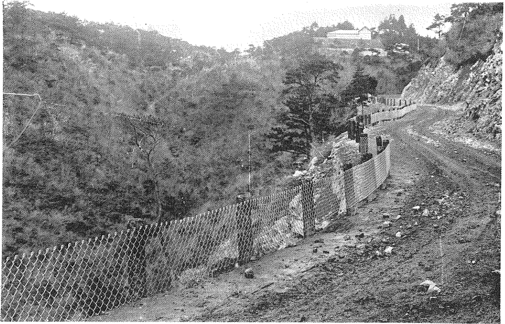
第 1 圖、兵庫縣六甲山登山道に施工された川崎式自動車保護網
