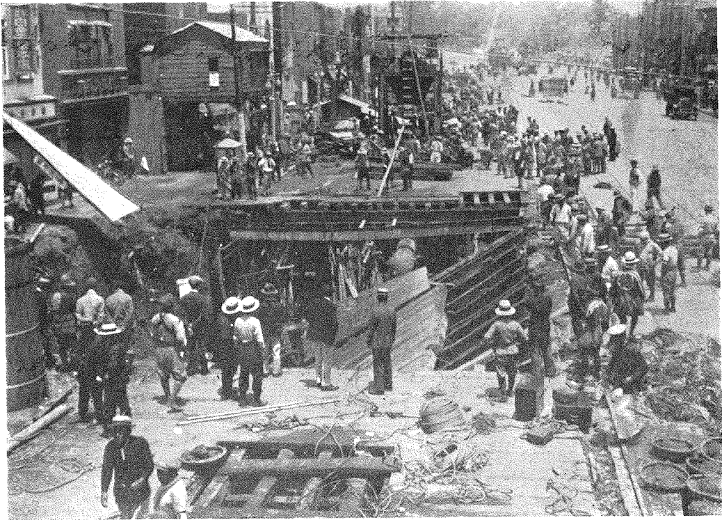
(1) 東京地下鐵道上野廣小路工事ヶ所六月二十九日陥落直後の狀景、左は歩道に接して商店街、右は市電軌道に接す、路盤の板張り、棧、桁等を露出してをる。崩壊は左側の土留I型鐵杭の下部が杭内に押出され、之につれて上部の鐵桁が墜落したものである。
