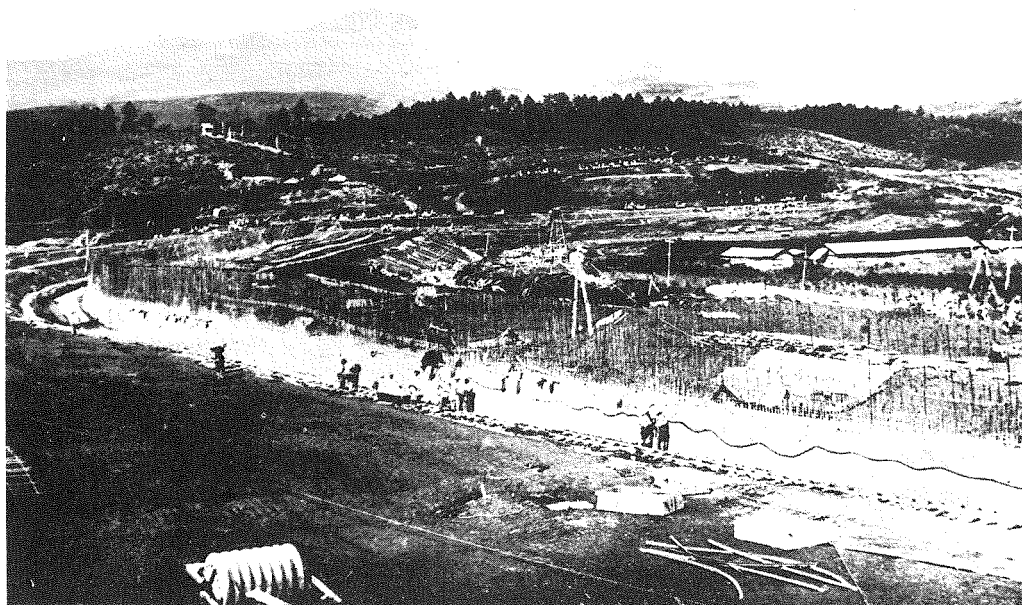
(2) 土堰堤工事、中心止水壁鐵筋組立中の景 (左下方にあるはローラー)
