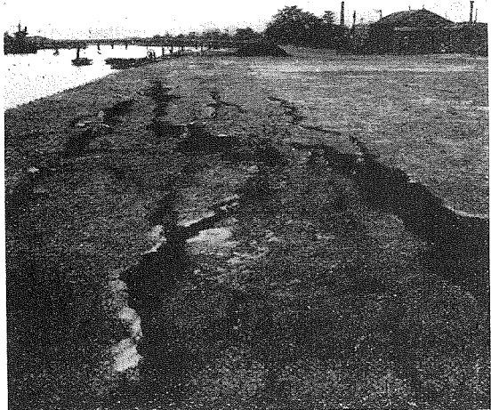
(4) 地震の爲め埋立地の龜裂 (地圖に於てNo6の箇所) 正蓮寺川北港大橋下流左岸、埋立地龜裂の狀況を示す。龜裂の幅二尺に及び高低一尺五寸位なり、方向は護岸に平行北東々を示す。 (4) Cracks Caused by the Earthquake.
