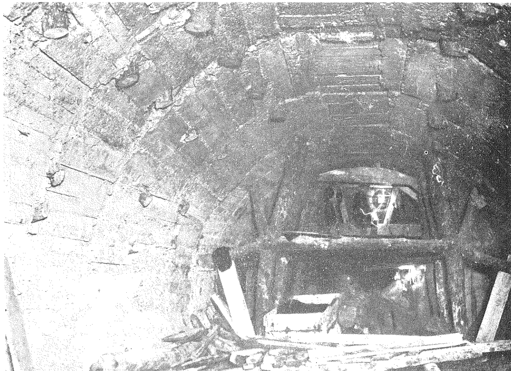
(12) 上久屋水路第四號隧道二重卷立部 外卷終了支保工を切り拂ひたる狀況
