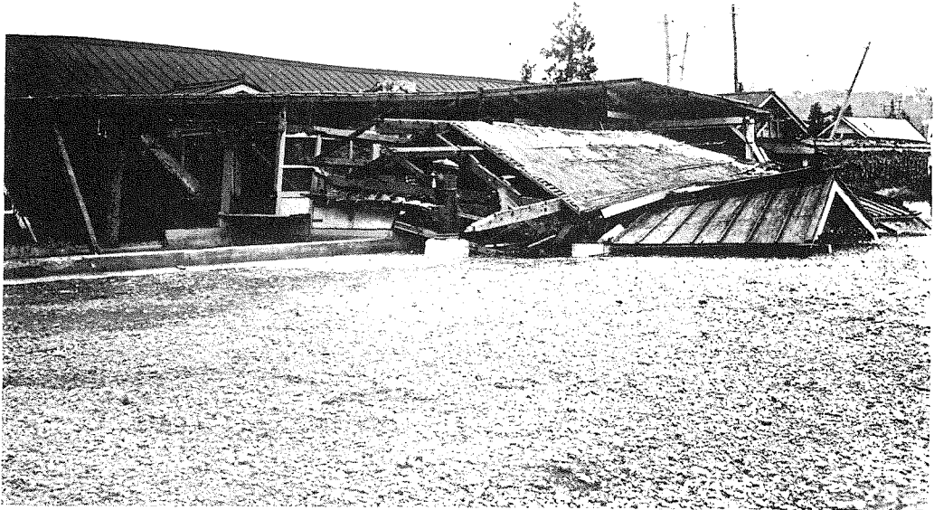
(13) 熱海線早川驛本屋倒壞の光景
