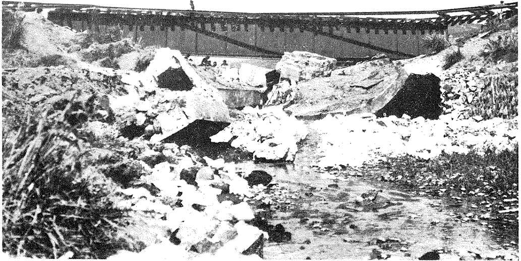
(5) 熱海線國府津鴨宮間江戸尻川橋梁崩壞箇所を下流より見たる光景
