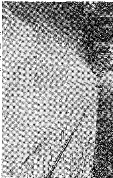
第五圖 同一箇所を其の儘アスファルトを以て一時復修を施行したる後の状態
