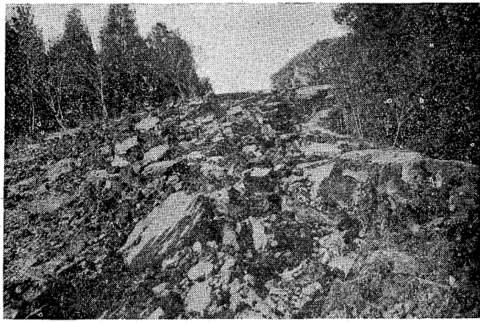
部一の所箇壊崩路道近附田新原笹村田錦線號一道國（圖四第）
