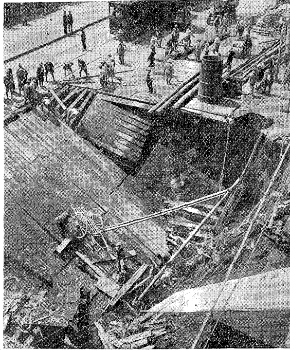
(一) 危ない地下鐵工事
