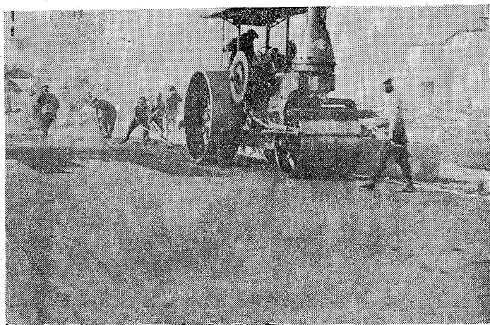
ナピ・トイナワ」の時二厚、場現裝鋪近附町津今、工裝鋪 業作「ゲンキール」及び「ゲンリーロ」の裝鋪「クツシリユ
