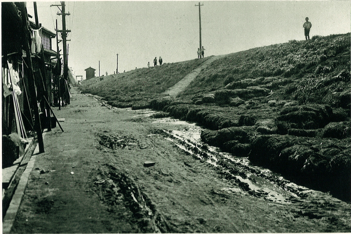
淀川左岸大阪市内傳法閘門上附近堤防法先ノ漏水滑落ニ對スル應急工作 (昭和十三年七月五日出水時)
