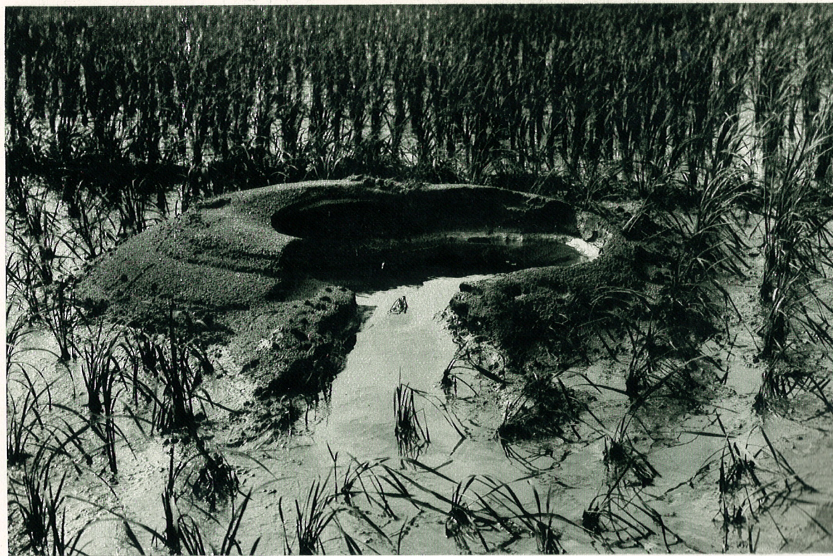
淀川右岸五領村前島地内堤防法先附近漏水狀況
