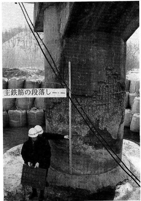
写真-1 松之恵橋橋脚の被害
