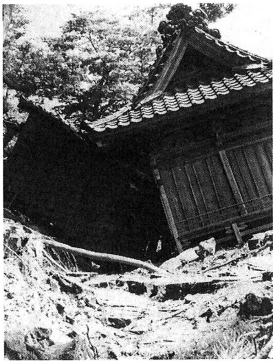
写真1 亀裂に落ち込んだ社
