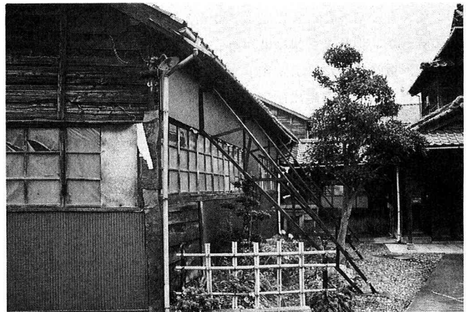
写真1 倒壊しなかった倉庫(図5中③)
