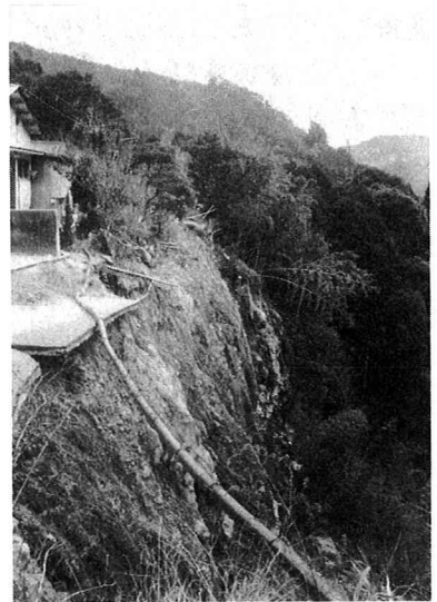
写真-1. 観測地点(榎本)の崖縁の道路の崩壊
