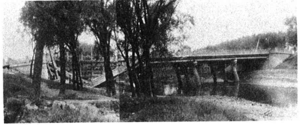
図7. 勝利橋の地震後の全景
