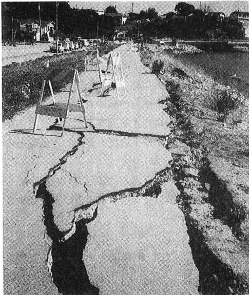
写真3 堤防の破壊 (サンタクルズ)
