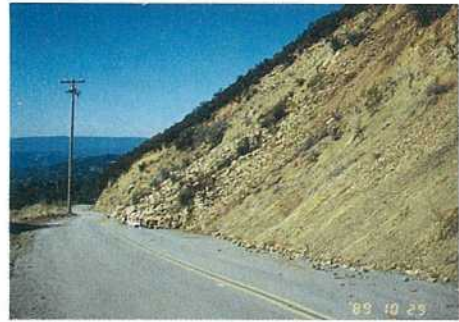
写真—11 サミット道路沿いの典型的な斜面崩壊
