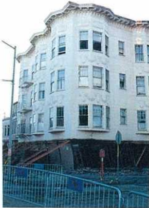
写真-5 マリーナ地区における建物の被害
