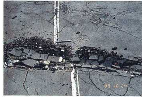
(a) ずれが生じた部分
