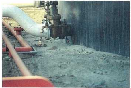
写真-8 石油タンク基礎での液状化
