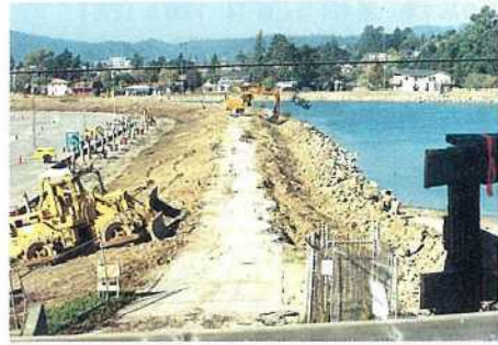
写真二 サンタクルスの河川堤防の被害
