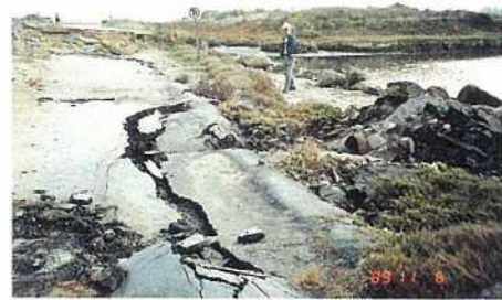
写真三 モスランディングの道路被害
