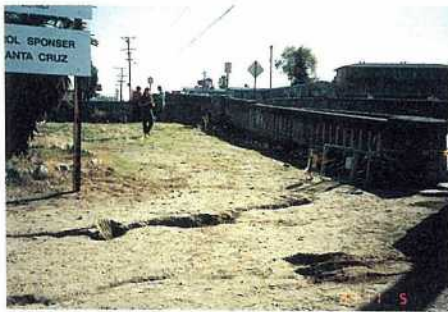
写真一 橋梁裏込めの沈下
