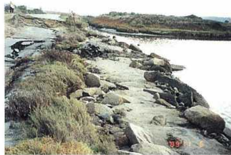
写真四 モスランディングの道路の変形・沈下と噴砂
