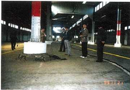
写真-29 第45埠頭の上屋の床の沈下, 段差
