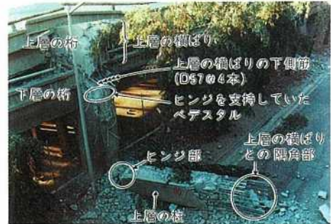
写真-7 タイプ1橋脚の被災状況 (上層の柱の下端にあるピンジ部とベDESTALの破壊により、上層の桁が完全に落下した。CALTRANS による)
