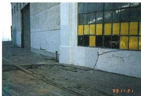
写真—31 第48埠頭の上屋の壁のクラックと埋立て地盤の沈下
