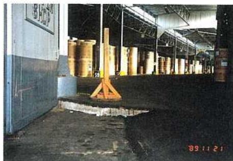
写真—30 第48埠頭の上屋の床の沈下
