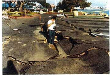
写真一28 Port View Parkの陥没、クラック (オークランド港湾局提供)
