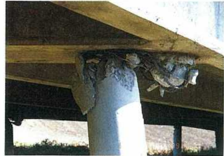
写真-15 RC柱頭部の破損と移動
