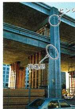
写真-9 下層の横ばり位置に生じた橋脚の損傷 (エンバカデロ高架橋, 上層の柱の上端にヒンジがある。図-10のタイプ3橋脚)
