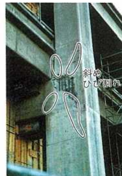
写真-10 写真-9のクローズアップ (主鉄筋が露出し、コンクリートの剝離した部分以外にも、大きく斜めひび割れが発生している)
