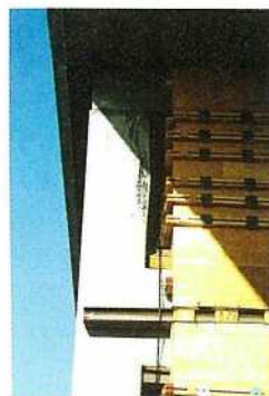
写真—12 上層の柱の上端に設けられたヒンジ部から縦方向に入ったひびわれ（I-280号線セルビイ通りの高架橋）
