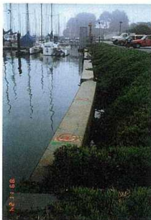
写真—32 サンタクルズ港の矢板式護岸の上部工のクラック、前傾
