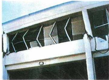
写真—36 サンフランシスコ空港の被災時の貨物ビル (空港事務所提供)
