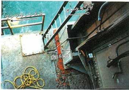
写真-2 E9上のトラス桁支柱のすべった痕跡
