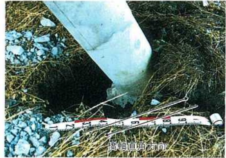
写真-16 桁の移動を示す杭周辺の地盤の空隙
