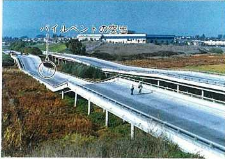
写真-14 ストラブスルー橋の被災状況
