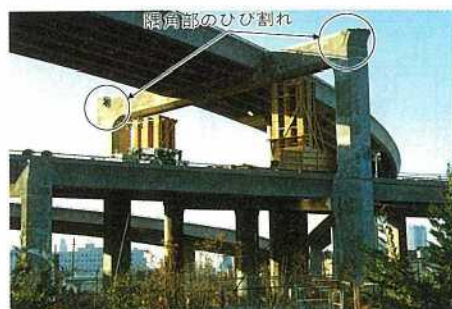
写真—13 上層の横ばりと柱のラーメン隅角部に入ったひびわれ（I-880号線ミッションクリーク付近の高架橋）
