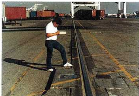
写真-25 APLターミナルの棧橋の背後地盤の沈下 (オークランド港湾局提供)
