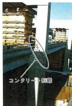
写真—11 下層の横ばり付近でせん断破壊した橋脚（I-280号線セルビイ通りの高架橋、写真—9に示したエンバカデロ高架橋の損傷と似ているが、損傷の位置が少し高くなっている）
