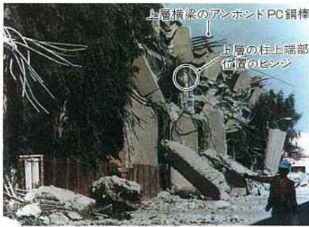
写真-8 タイプ2橋脚の被災状況（上端に設けられたヒンジが破壊し、落下した上層の柱、柱下端の鉄筋でかろうじてつながっている。上層の横ばり部ではアンボンドPC鋼棒が抜け出しているのがわかる。CALTRANSによる）
