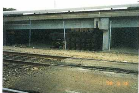
写真-21 オークランド側高架橋へのアプローチ部の被害
