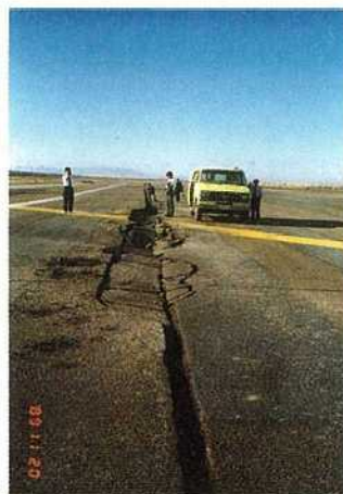
写真-34 オークランド空港の滑走路のクラックと陥没
