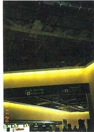
写真—35 サンフランシスコ空港ターミナルの調査時の天井
