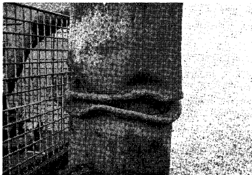
写真—4.2 座屈した 16 in ライン
