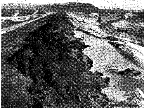
写真-3.1 Lower ダムの被災状況
