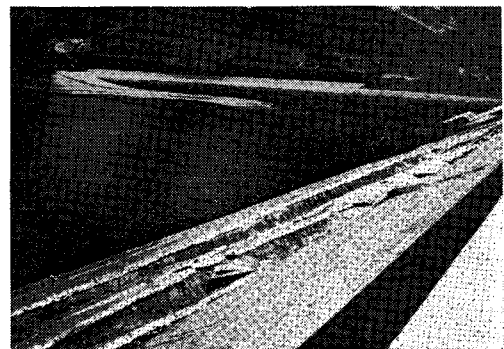
写真-3.2 Upper ダム上流面の破壊
