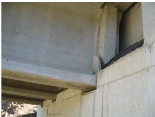
写真-5 Puerto de Lirquen 高架橋の桁端部の軽微な損傷
