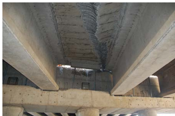
写真-6 桁と床版の接合部付近から橋軸方向に沿って生じた損傷 (Llacolen 橋へのアプローチ橋)
