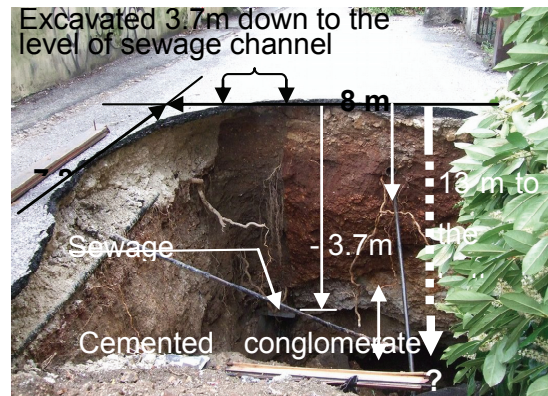
写真-7 自然空洞の崩壊による路面陥没 (図-3 参照)
