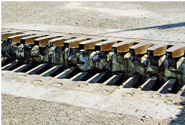
写真-9 ジョイントの段差(文献3)による)
