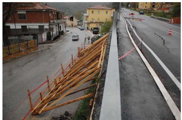
写真-17 沈下した路面
