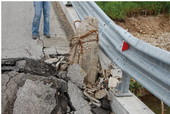
写真-15 床版を突き破って突出した橋脚
