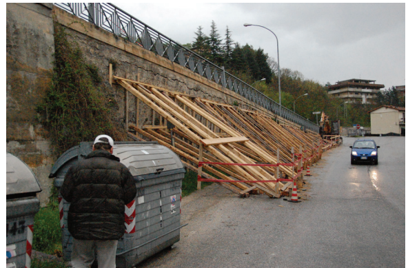
写真-16 盛土の変形とこれに対する応急復旧
