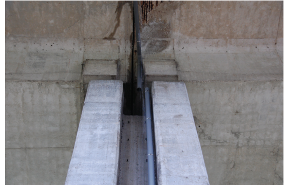
写真-11 橋軸方向への桁の残留移動
