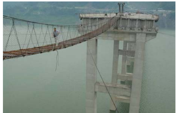
図-9(2) 廟子坪大橋 桁の落橋
