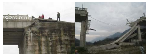
図-8(3) 落橋した桁とP2橋脚 図-8(4) A2橋台の被害
