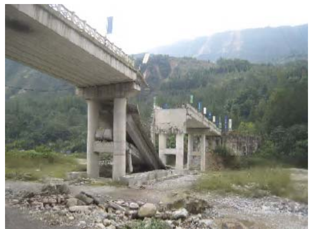
図-8(2) 高原大橋桁の落橋（A2側から望む）
