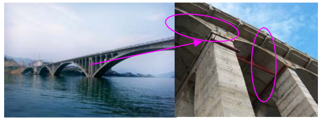
図-4 白水大橋：サブリップの亀裂
