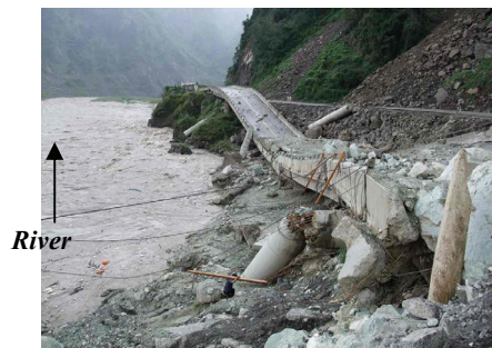
写真-7 人為的に爆破された高架橋
