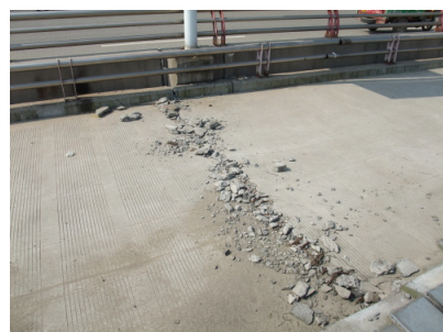
写真-18 伸縮継手部の損傷
