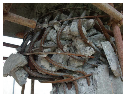
写真-12 代表的な橋脚の被害
