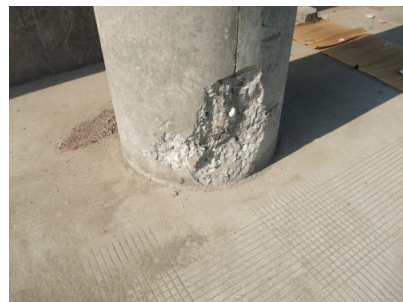
写真-15 円柱式橋脚基部の被害
