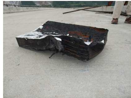
写真-5 損傷を受けた積層ゴム支承
