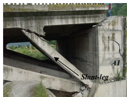
写真-10 損傷したA1橋台
