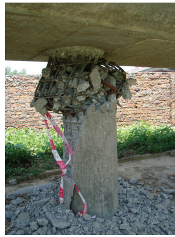
写真-14 代表的な円柱式橋脚のせん断破壊
