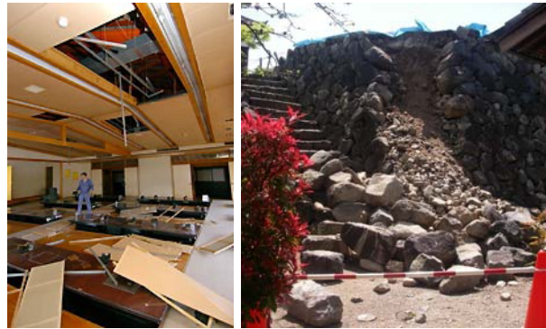
(a) 天井パネルの落下 (b) 亀山城の擁壁の崩壊 写真—4：亀山地震による被害
