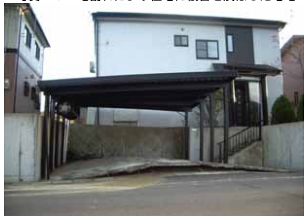
写真 - 7 液状化により駐車場の 50 cm 程度の隆起
