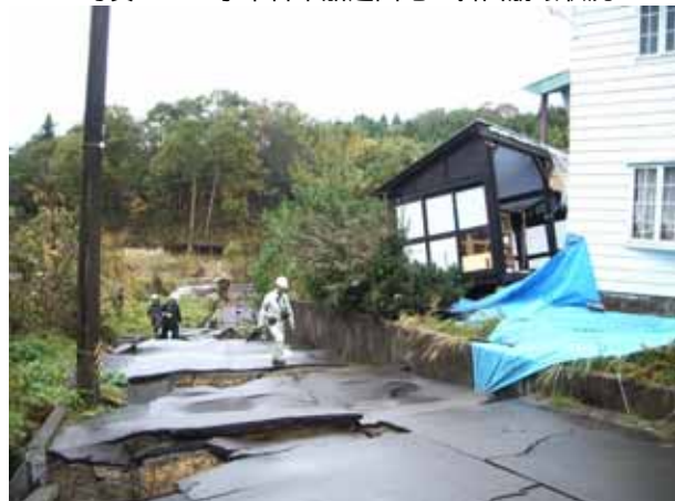
写真-11 長岡市鶴ヶ丘団地の斜面崩壊状況
