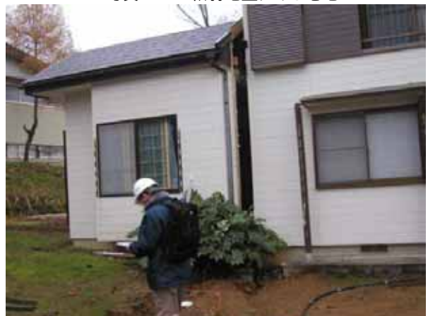
写真 - 6 地割れにより住宅に被害を及ぼした宅地
