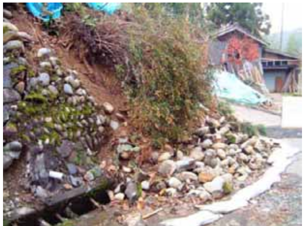
写真 - 1 裏込めコンクリートがない空積み擁壁
