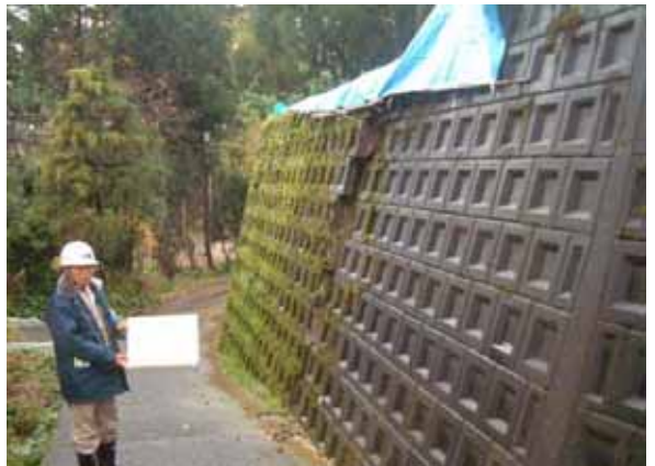
写真 - 4 水抜き穴がなく危険な練積み擁壁
