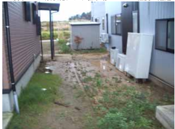
写真 - 8 宅地地盤の液状化による家屋の沈下・傾斜
