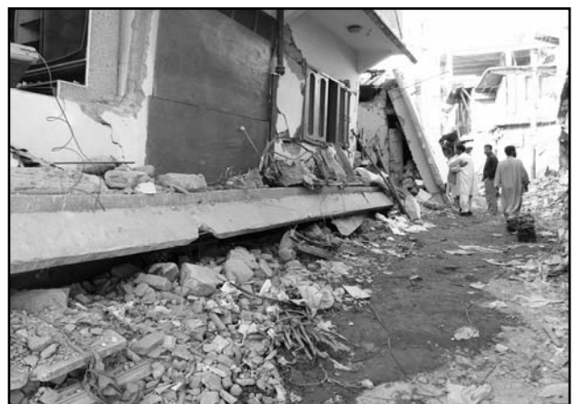
写真 11 一階が押しつぶされた建物
