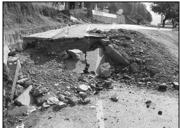
写真 8 道路に生じた段差
