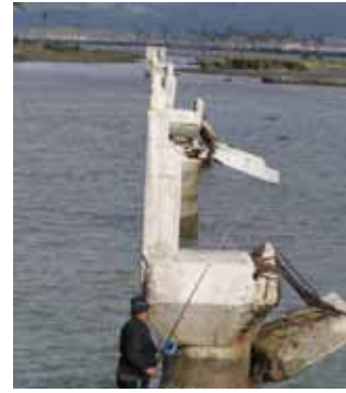
写真 - 3 津波被害を受けた橋脚
