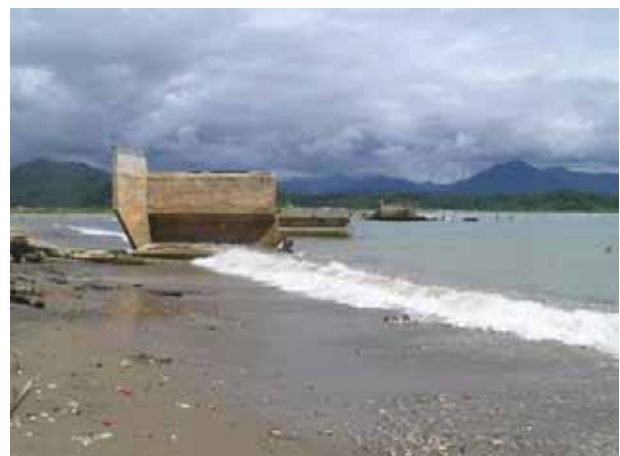
写真 - 1 損傷ランク A の橋の被害状況 (No. )
