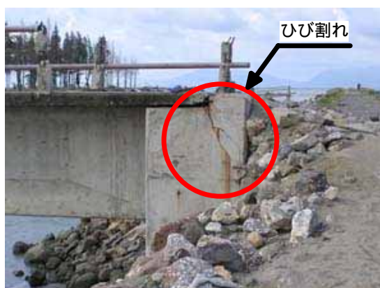
写真 - 2 津波被害を受けた橋台
