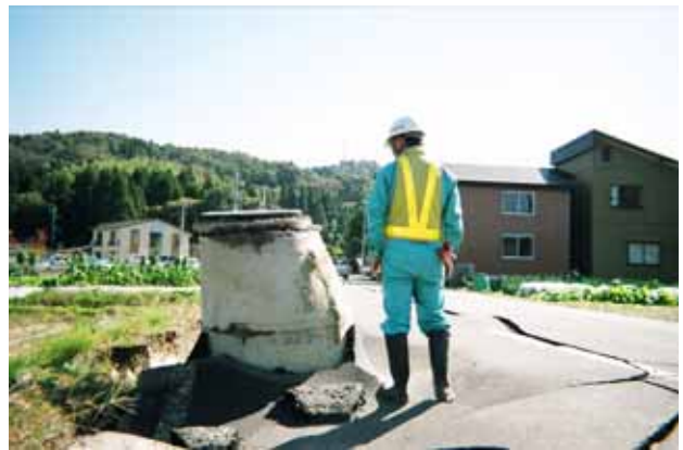
写真-2 マンホール突出状況
