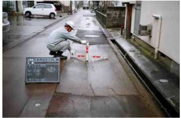
写真-1 開削部沈下状況
