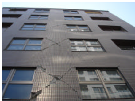
写真 - 5 新しいマンションの外壁のせん断亀裂
