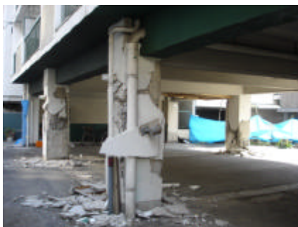
写真 4 ピロティ形式の5階建てアパート（竣工1966年）の1階柱のせん断破壊
