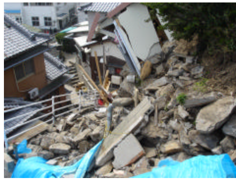
写真 - 7 家屋・宅地崩壊による道路閉塞
