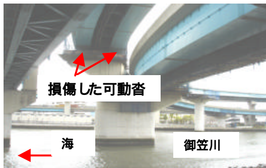
写真 - 1 支承が破損した曲線桁橋
