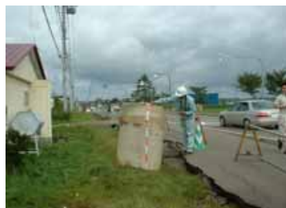
写真 3 音別町で浮き上がったマンホール
