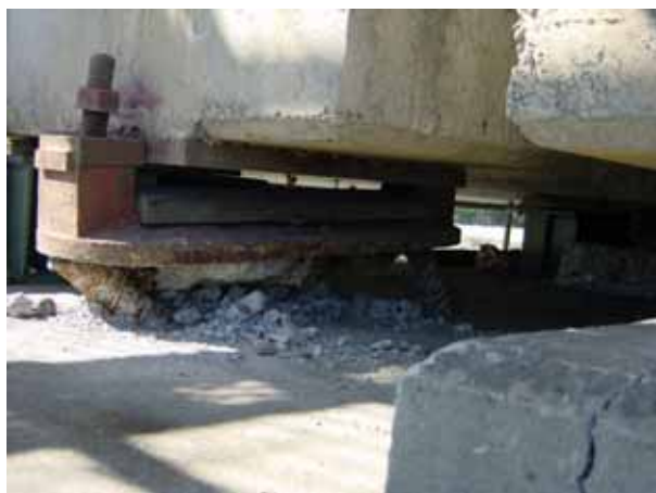
写真8 歴舟橋 アンカーボルトの浮き上がり
