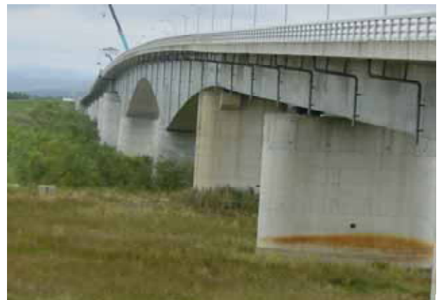
写真 6 遠方左岸側の橋軸折曲り（十勝河口橋）
