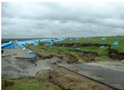
写真 5 十勝川河口付近の堤防の被害
