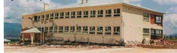
写真-5：校舎の被害状況
