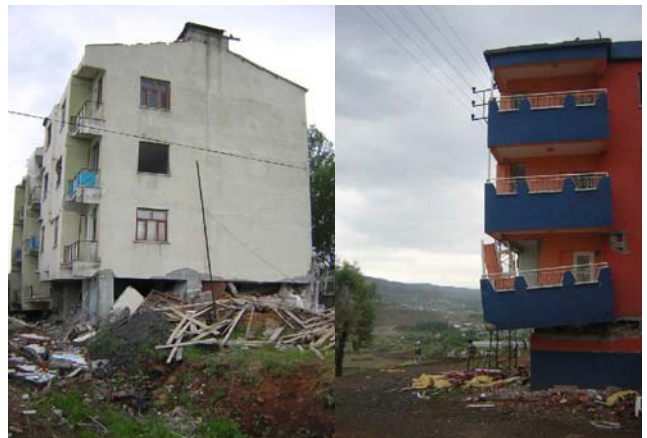
写真-6ビンギョル市における台地の縁部で大破の建物
