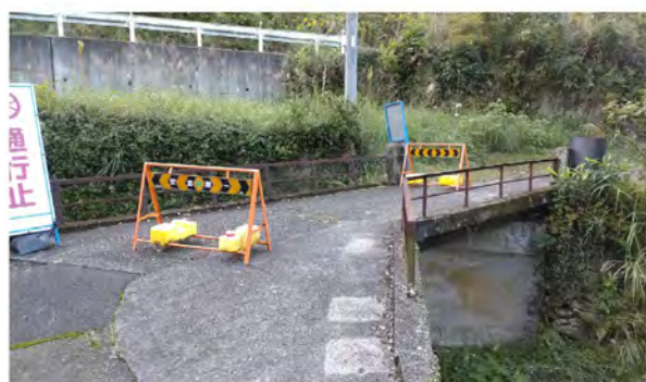
A橋：橋長7m、幅員2m、判定Ⅲ 通行止(二輪車、歩行者は可)
