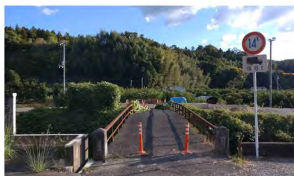
B橋：橋長19m、幅員3m、判定Ⅲ 通行止(二輪車、歩行者は可)
