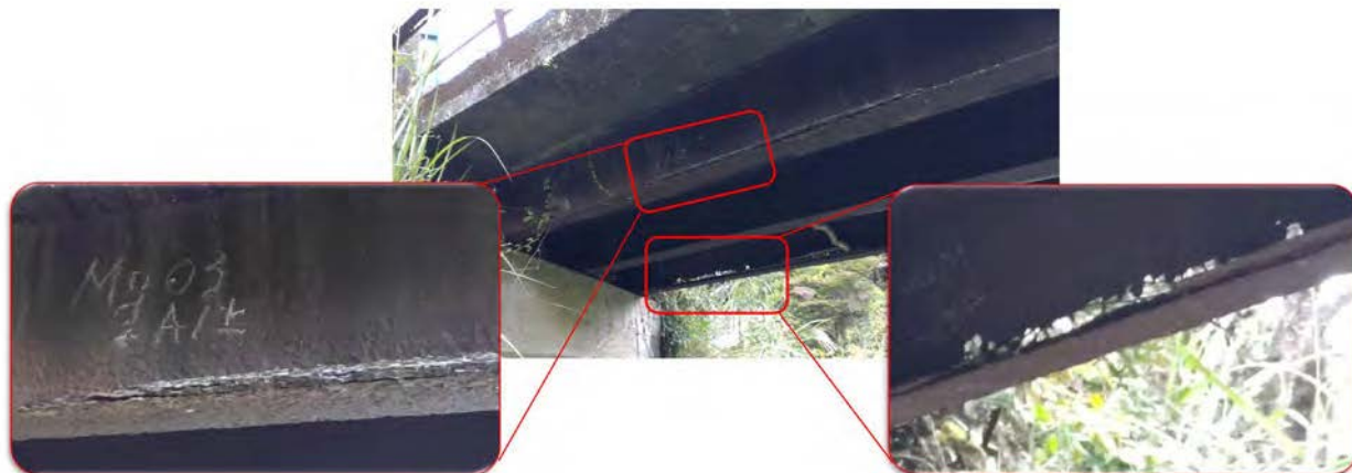
写真-3.6.2 通行規制した橋梁(鋼橋)の主桁の腐食 (写真-3.6.1 の A 橋)
