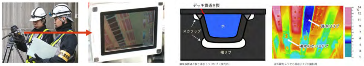
写真-3.6.4 赤外線サーモグラフィ法を活用した鋼床版の疲労き裂の調査(首都高速) (3.6.5) (出典：首都高技術株式会社ウェブサイト, 2024.12)
