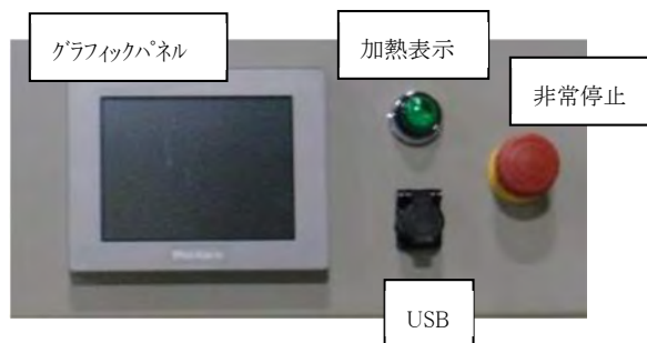
(d) 電源装置パネル
