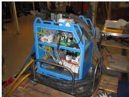
(b) 電源装置外観
