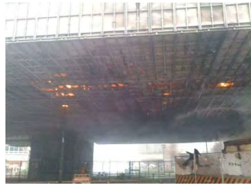
図-2.3.6 火災発生例 [2.2]
