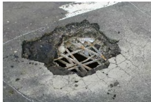
写真-1 RC 床版の押抜きせん断破壊事例
