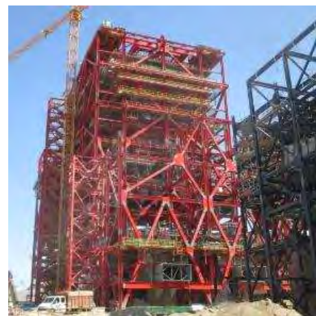
写真-1 2 火力発電所建屋鉄骨の事例
