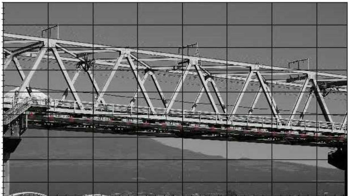
トラス橋の変形
