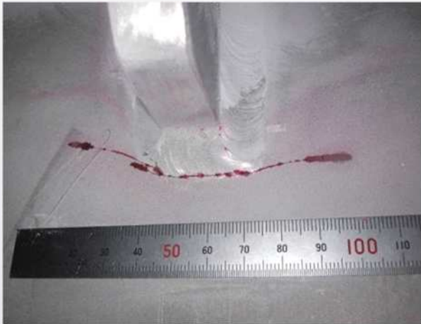
鋼道路橋における疲労亀裂
