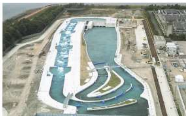
写真-1 カヌー・スラロームセンター全景 (提供: 東京都 2019年4月撮影)
