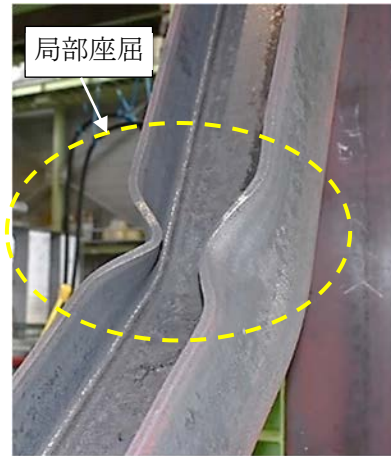
(c) ブレース材の局部座屈
