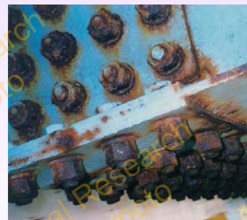
素地調整困難箇所 での腐食例
