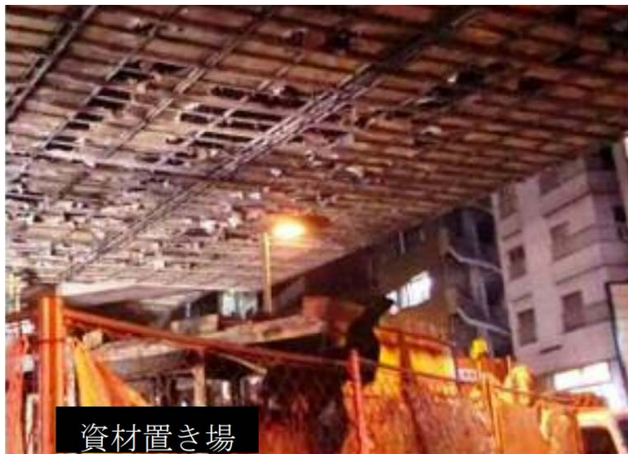
【足場の損傷状況】
