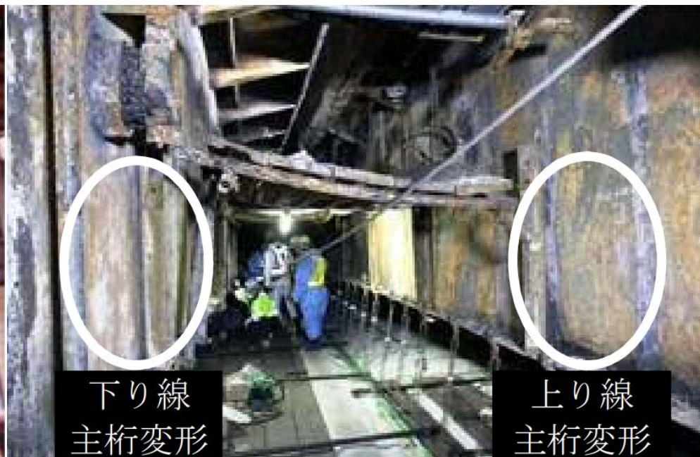
【主桁の一部変形状況】
