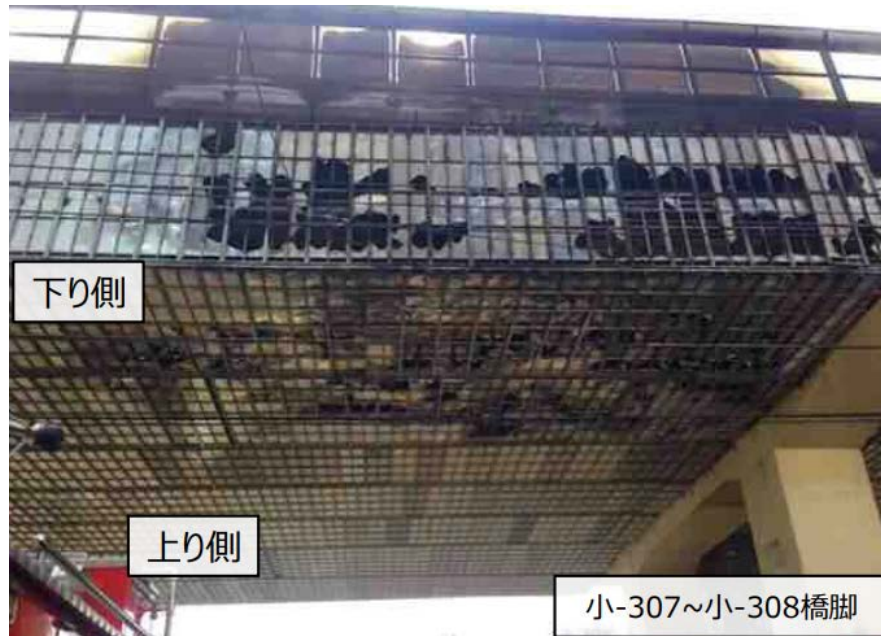
【足場の損傷状況】
