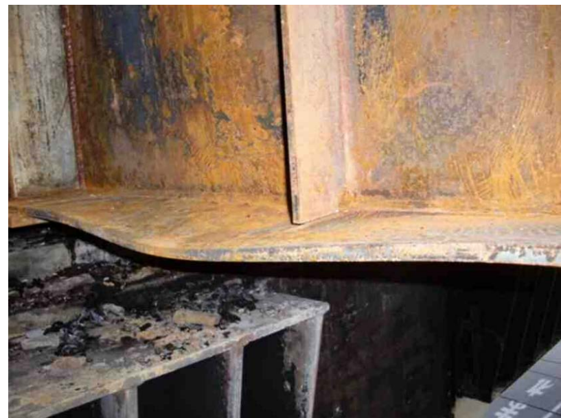
【主桁の一部変形状況】
